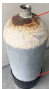
① タンク外側がサビていないか
